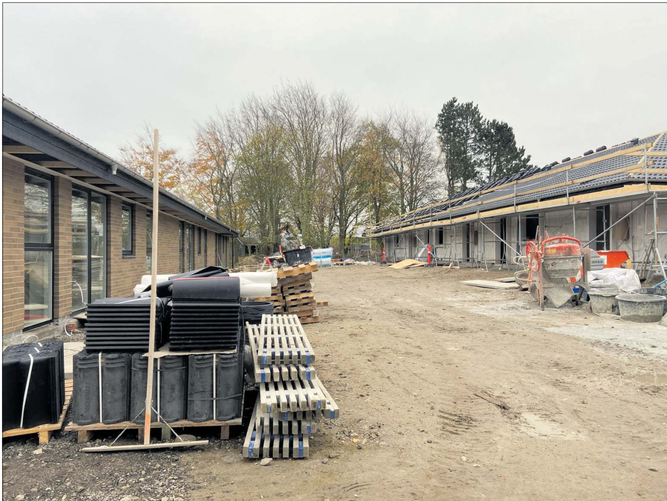
Byggeriet af Golfhaven i Gammel Rønnede er godt på vej, som man kan se her på avisens billede, der er taget forrige søndag. Men der bliver først indflytning i september 2023, når alle 32 rækkehuse er bygget, og de udendørs anlæg er på plads. Foto: Nikolaj Rasch Skou
